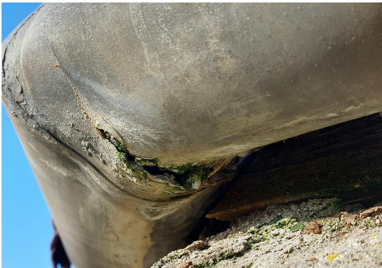
Poškodenia zinkového materiálu na primárnom žľabe apsidovej časti strechy.
