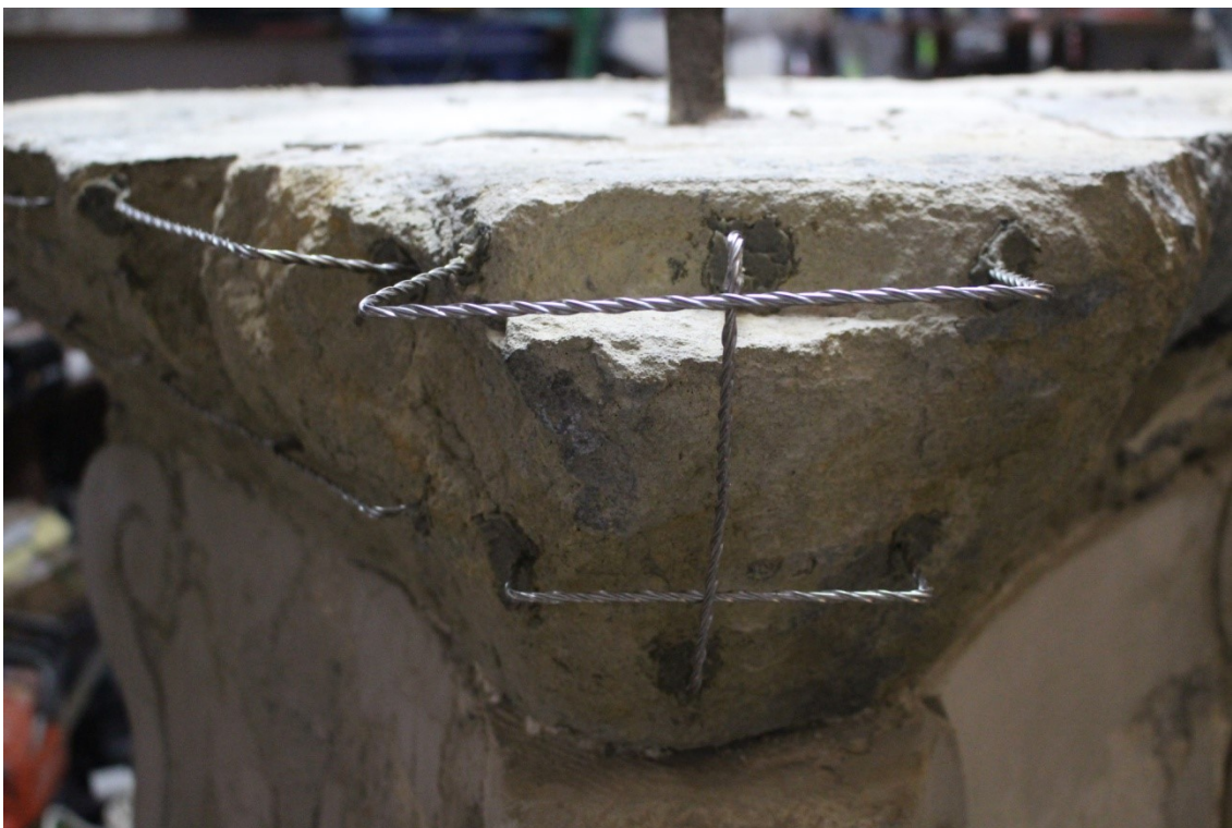
Antikorózne tordované premostenia tvoriace nosnú konštrukciu tmelov profilovanej hlavice podstavca
